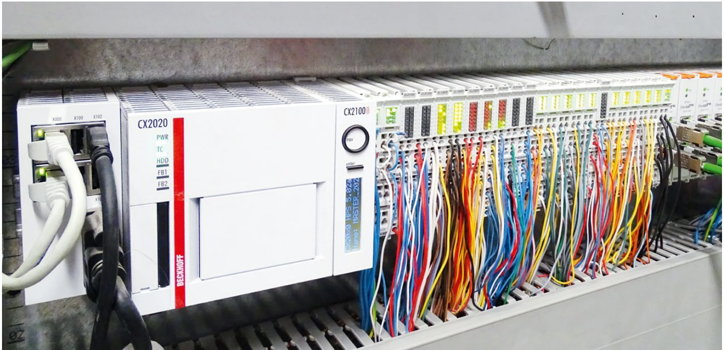
Als zentrale Intelligenz der Gebäudeautomation dient ein Embedded-PC CX2020, der über EtherCAT mit 89 dezentralen Inseln – nämlich einer pro Raum – mit in Summe über 700 I/O-Modulen verbunden ist.
