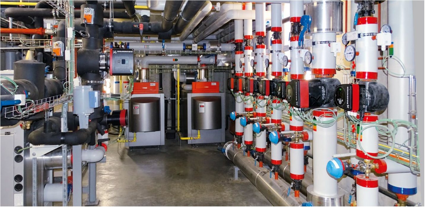
Die HKL-Regelung des Universitätsgebäudes umfasst mehr als 4.000 I/O-Punkte.
