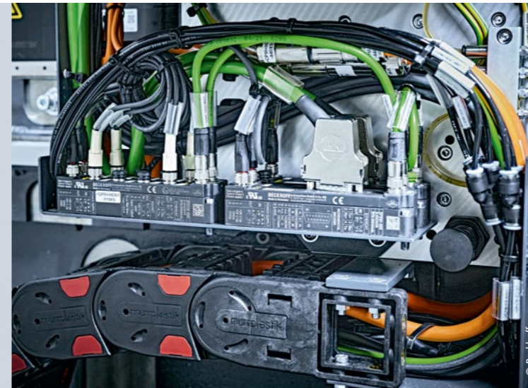
Das breite I/O-Spektrum an IP20-EtherCAT-Klemmen und IP67-EtherCAT-Box-Modulen (hier: EP2338 und EP5101 in der BLS 500) erleichtert die Modularisierung der Manz-Anlagen.
