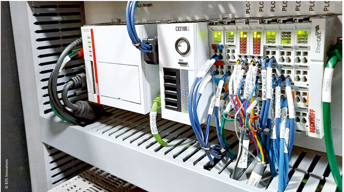
Ein Embedded-PC CX2040 von Beckhoff liefert ausreichend Rechenleistung für die Koordination der fünf Bewegungsachsen der Hochgeschwindigkeits-Laserschneidmaschine.
